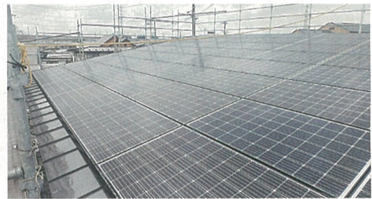
屋根には24kWの太陽光発電を搭載。全量買取だが年間発電量は全住戸の電力消費量に相当し、実質的にはネット・ゼロになるとい
